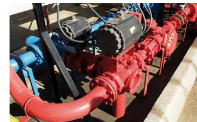
Válvula para carga de combustible Fueling valves
