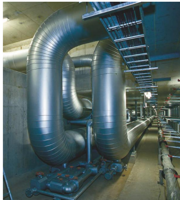
Regional cooling conduit
